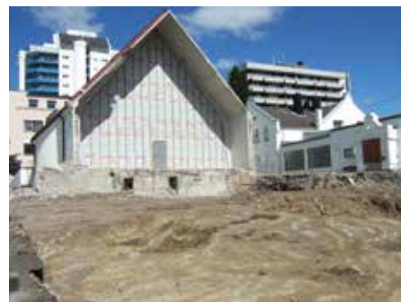
Kirketårnet og inngangspartiet er revet. Tomten for nybygget ligger klar. Det er juli 2010.
